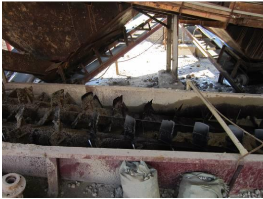
矿砂搅拌水清洗机（现已拆除）
